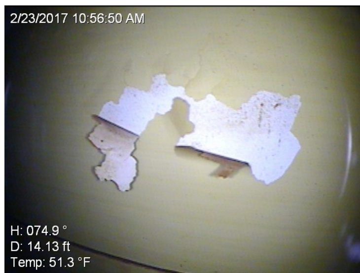
47) Topcoat delamination on the sidewall.
