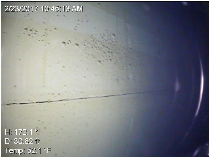
49) Blistering on the sidewall.
