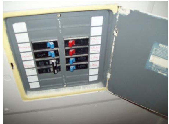
Photo #58: Tenant breaker panel
