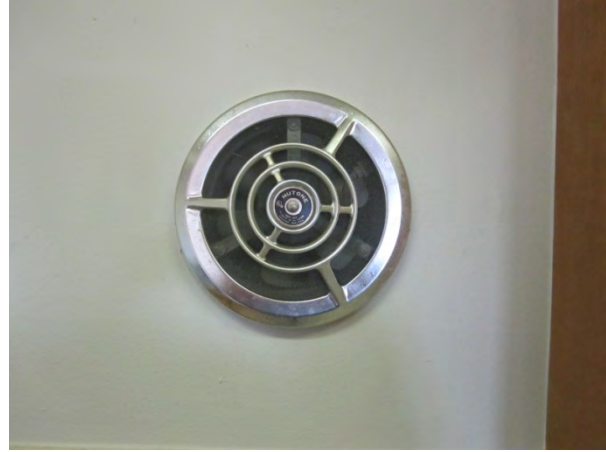
Photo 14: Tenant unit exhaust fan
