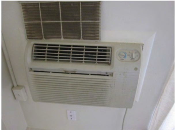
Photo 10: Tenant air conditioner
